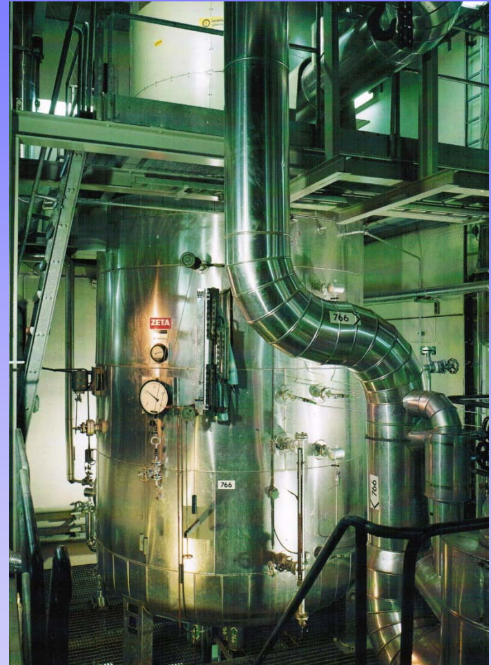
Ringhals – 20MW, 6.6kV
